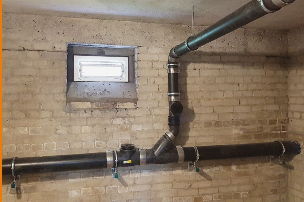
Leichter Zugang durch Leitungsverlauf im Haus
